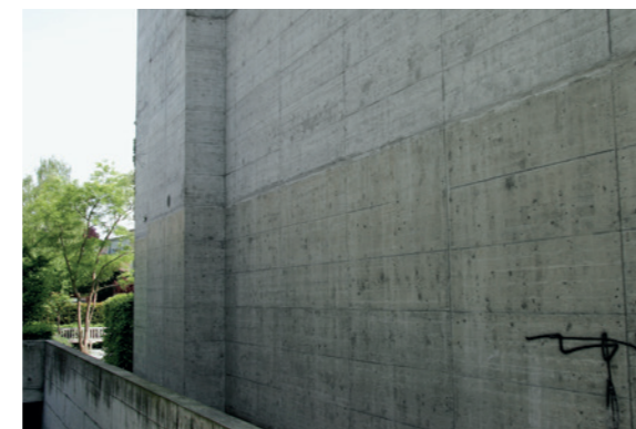
Fig. 39 Influence d'une protection anti-graffiti sur la teinte du béton (zone inférieure).
