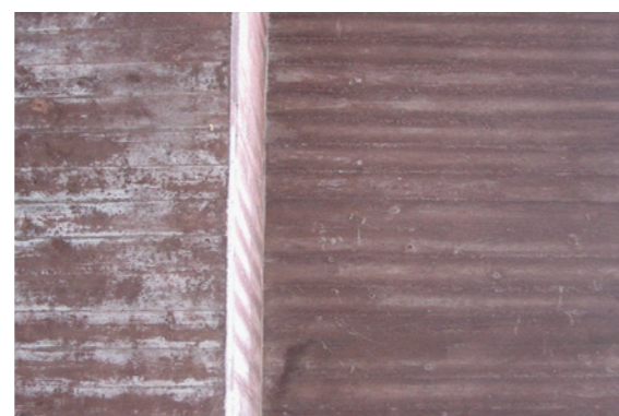
Fig. 41 L'élément décoffré par temps de pluie (à gauche) présente des efflorescences.
