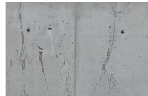
Fig. 43 Remontées d'eau le long du coffrage.
