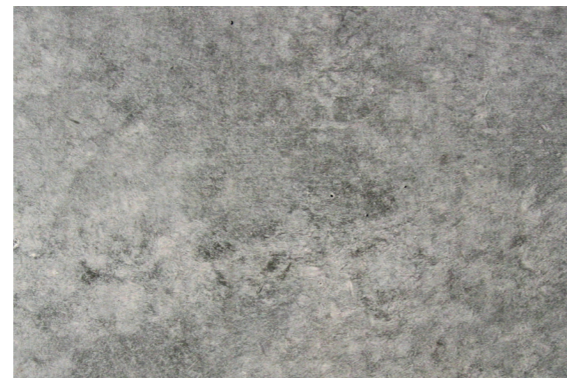
Fig. 40 Marbrures claires et foncées dues à un bétonnage en conditions hivernales.
